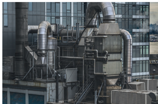
Lavador de gases
