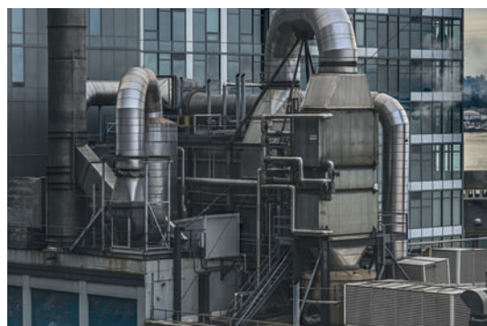
Lavador de Gases
