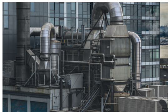
Lavador de gases
