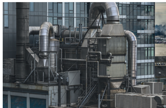
Lavador de gases
